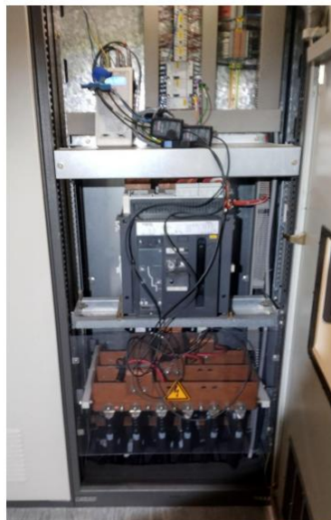
Abbildung 7.1: Einbausituation der Messtechnik des Feldtests beim Wupperverband
